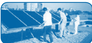
Abbildung 76: Aufbau der Solaranlage an der Schule Quelle: Alexander-von-Humboldt-Schule
