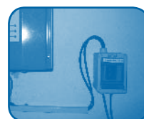
Abbildung 1 und 2/a: Photovoltaikanlage der Askanischen Oberschule Quelle: Askanische Oberschule und eigene Aufnahme
