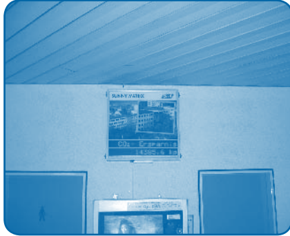
Abbildung 38: Anzeigetafel der Solaranlage Quelle: Wirtschaftsschule Gunzenhausen
