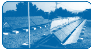
Abbildung 70 und 71: PV-Anlage auf Drehgestell und V-Trog-Spiegelsystem
